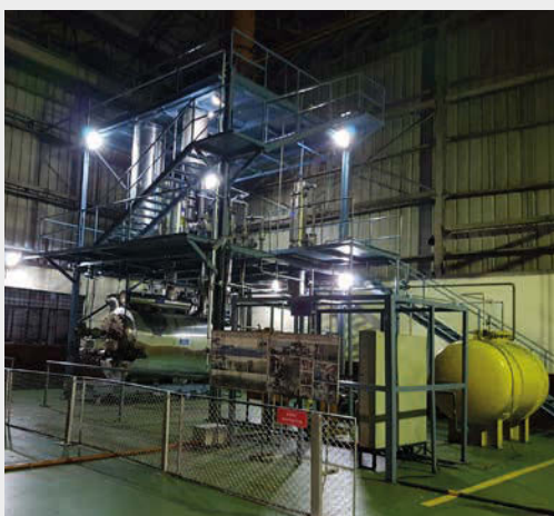
Een installatie van Patpert in India. De technologie leidt tot een aanzienlijke (30 procent) reductie in CO 2 -uitstoot ten opzichte van gangbare diesel (bron: LCA-studie, Avans).
